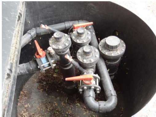
Abbildung 11: Gasbrunnen 3.11 mit drei Entgasungsrohren und einem Sickerwasserförderrohr (DA I)
